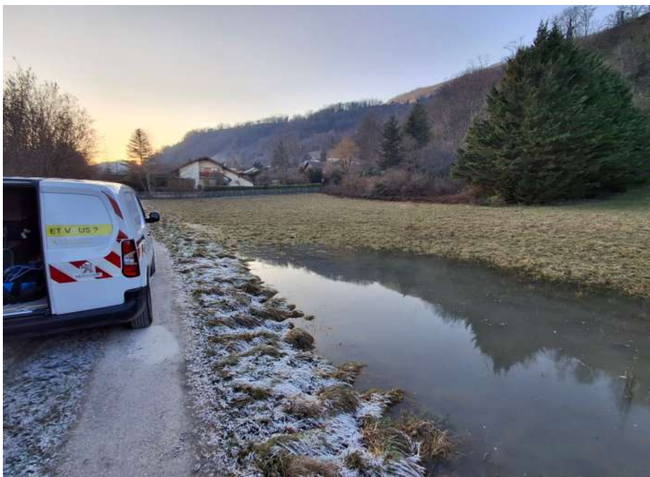
Conséquence d'une casse de canalisation en fonte DN100 pendant les grands-froids de l'hiver 2025 – St Etienne de Crossey
